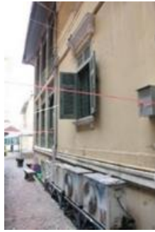
ข) บริเวณด้านข้างติดกับอาคาร คอนกรีตที่สร้างขึ้นภายหลัง มีการทวดตัวลง
