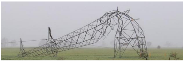
รูปที่ 3 การวิบัติจากการโก่งเดาะในชิ้นส่วนรับแรงอัดของโครงสร้างหอสายส่งไฟฟ้า [9]
