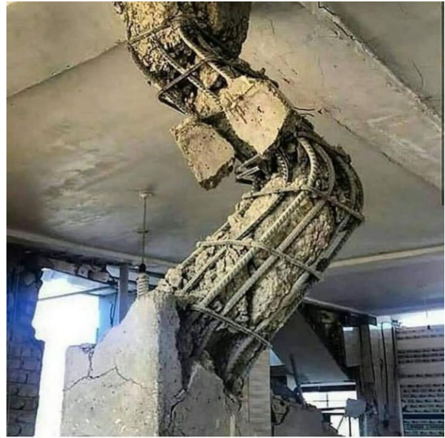
รูปที่ 1 การวิบัติจากการโก่งเดาะของเสาในอาคาร [7]
