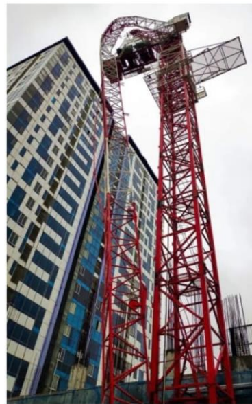
รูปที่ 2 การวิบัติจากการโก่งเดาะในชิ้นส่วนรับแรงอัดของโครงสร้างทาวเวอร์เคลน [8]
