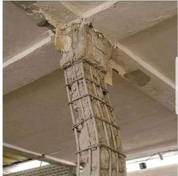
รูปที่ 1 การวิบัติจากการโก่งเดาะของเสาภายในอาคาร [6]
