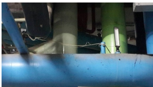
รูปที่ 6 ตำแหน่งติดตั้งอุปกรณ์วัดอุณหภูมิของท่อน้ำเย็นขึ้นอาคาร 11 (ทอสีฟ้า)
