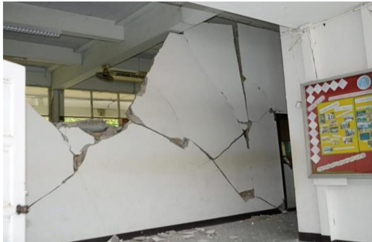
รูปที่ 1 ความเสียหายในผนังอิฐก่อเนื่องจากแรงแผ่นดินไหว
