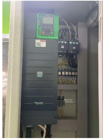
หลังการติดตั้งอินเวอร์เตอร์
