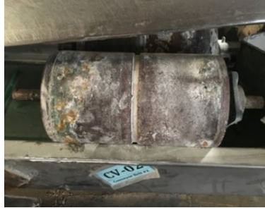
รูปที่ 6 การติดโกดไว้ที่หลังแผ่นสายพานของลูกกลิ้งสายพานและร่องการเคลื่อนที่ของขอบใต้สายพาน
