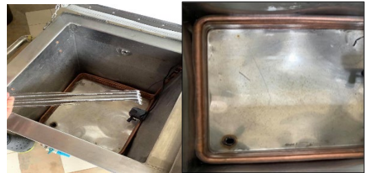
รูปที่ 10 ชั้นน้ำแข็งที่เกาะบริเวณคอยล์ทำน้ำเย็น
