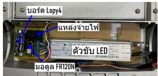
รูปที่ 7 โคมไฟที่ปรับปรุงประกอบเข้ากับบอร์ดควบคุม
