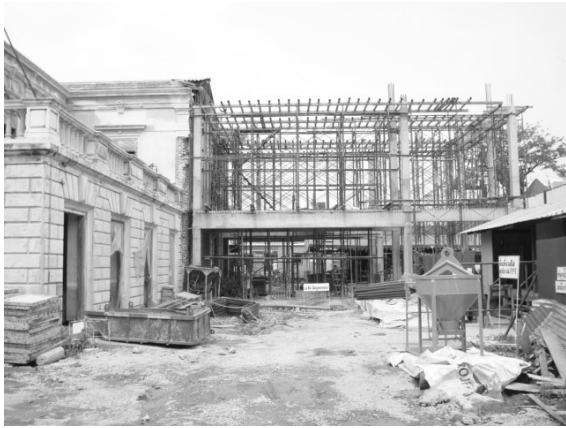
รูปที่ 9 ส่วนต่อระหว่างอาคารที่ซ่อมแซมและเชื่อมต่อกับ ห้องทางทิศใต้หมายเลข 121 และ 124
