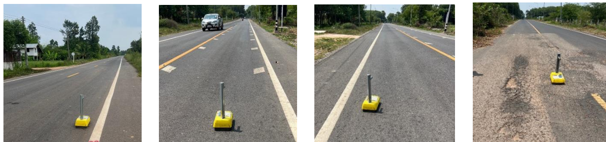
(ก) FWD น้อยกว่า 0.30 มม. (ข) FWD 0.30-0.50 มม. (ค) FWD 0.50-0.70 มม. (ง) FWD มากกว่า 0.70 มม.
