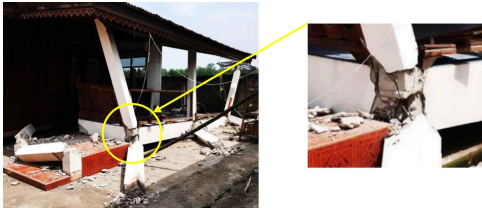
รูปที่ 1 การวิบัติของเสาและความเสียหายของบ้านพักอาศัย [6]
