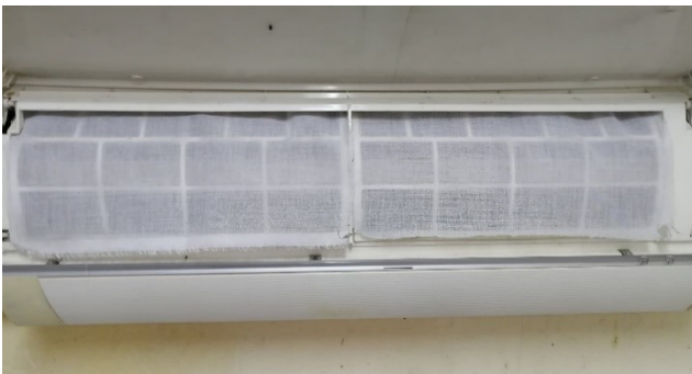
รูปที่ 7 ที่สภาวะแผ่นกรองอากาศสกปรก
