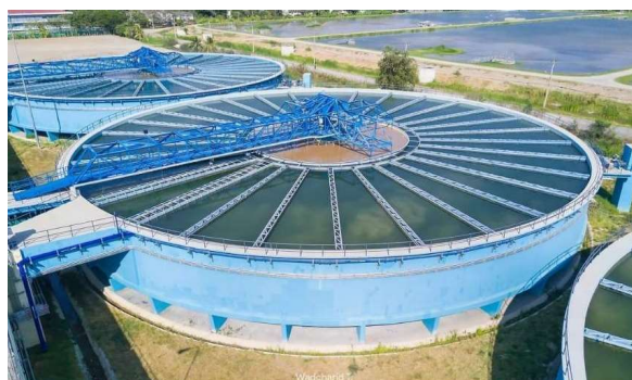
รูปที่ 1 ถังตกตะกอนชนิดหมุนเวียนตะกอน
