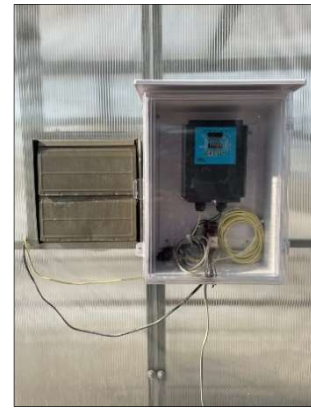
รูปที่ 2 กล่องควบคุมพัดลมดูดอากาศและหน้าจอแสดงผล
