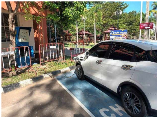
รูปที่ 22 การทดสอบเครื่องอัดประจุกับยานยนต์ไฟฟ้ายี่ห้อ NETA ที่ถ่ายจากภาพจริง
