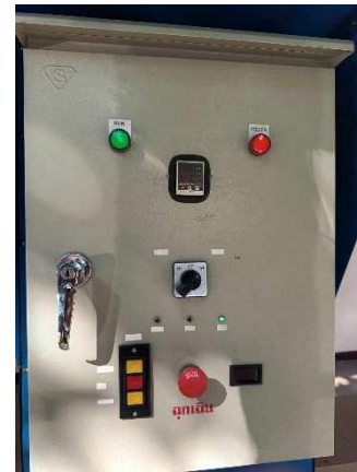
รูปที่ 10 แผงควบคุมยานยนต์ไฟฟ้าขณะทำการอัดประจุที่ถ่ายจากภาพจริง
