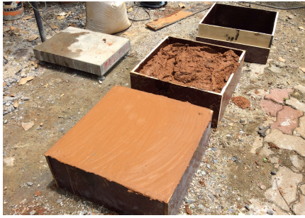
รูปที่ 7 การเทบล็อกผนังดินซีเมนต์ผสมน้ำยางพารา
