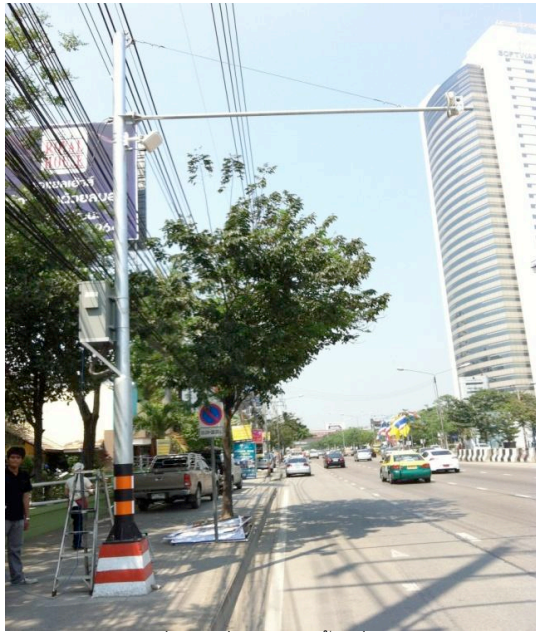
รูปที่ 4 จุดที่ทำการติดตั้งเครื่องมือ
