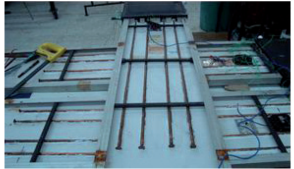
รูปที่ 5 ชุดท่อความร้อนที่ติดตั้งไว้ด้านหลังแผงเซลล์แสงอาทิตย์
