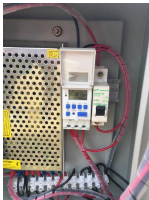
รูปที่ 5 ระบบควบคุมไฟฟ้าแบบตั้งเวลาอัตโนมัติ
