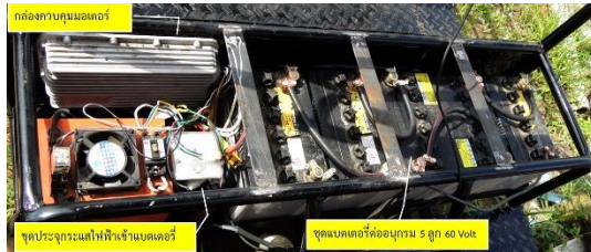
รูปที่ 14 อุปกรณ์ชุดประจุกระแสไฟฟ้า
