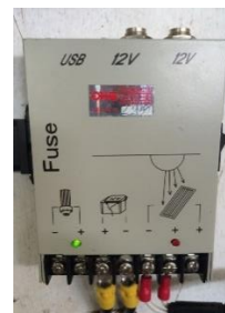
ภาพที่ 7 ติดตั้งเครื่องควบคุมการชาร์จ
