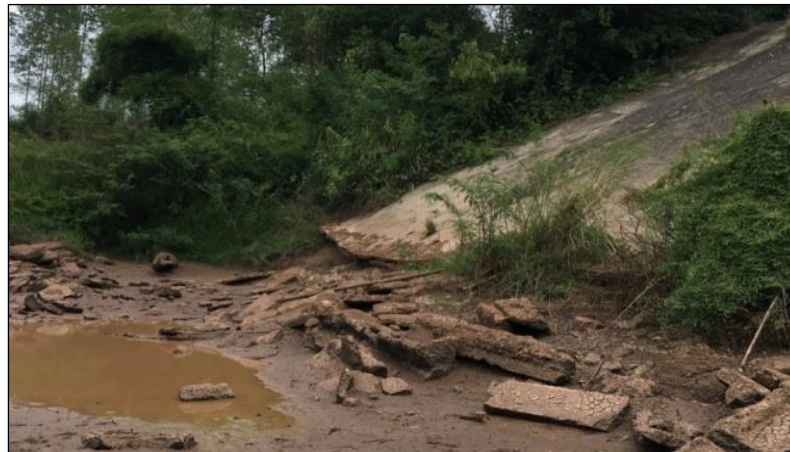
รูปที่ 3 แสดงความเสียหายที่เกิดจากการกัดเซาะที่ส่วนปลายของเชิงลาด (Toe Slope)
