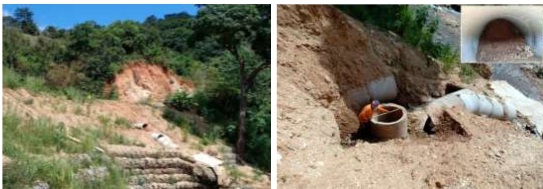
ภาพที่ 2 ความเสียหายหลังการบูรณะเมื่อปี พ.ศ.2562 และปัญหาที่เกิดขึ้นบริเวณท่อระบายน้ำใต้ผิวทาง
