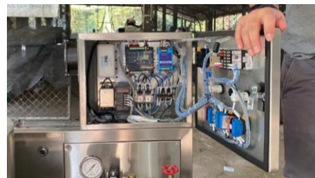
รูปที่ 13 ภาพภายในระบบต้มน้ำอัตโนมัติรวมถึงระบบส่งข้อมูลผ่านแอปพลิเคชัน
