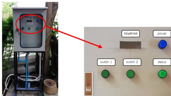
ภาพที่ 6 ระบบเฝ้าระวังคุณภาพน้ำแหล่งน้ำสาธารณะ และอุปกรณ์หน้าตู้ควบคุม
