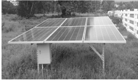
รูปที่ 2 แผงเซลล์แสงอาทิตย์แบบผลึกรวม Poly crystalline ยี่ห้อ Jinko Solar กำลังไฟฟ้าขนาด 270W
