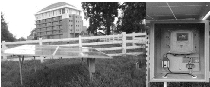
รูปที่ 4 ชุดอุปกรณ์แผงและระบบควบคุมของระบบสูบน้ำเซลล์แสงอาทิตย์
