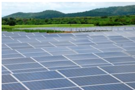
รูปที่ 15 โรงไฟฟ้าพลังงานแสงอาทิตย์
