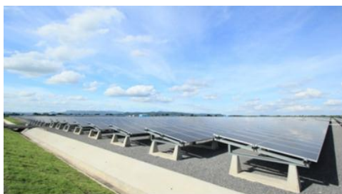
รูปที่ 2 Solar Farm สำหรับผลิตกระแสไฟฟ้า [2]
