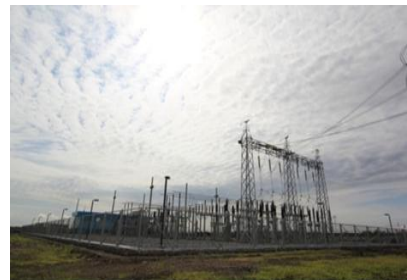
รูปที่ 1 โรงไฟฟ้าพลังงานแสงอาทิตย์ [1]
