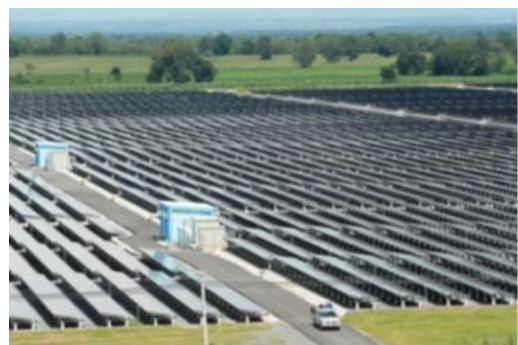
รูปที่ 14 โรงไฟฟ้าพลังงานแสงอาทิตย์ “ลพบุรี โซลาร์” [8]
