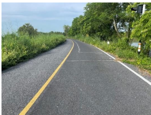
รูปที่ 1 รอยแตกร้าวจากงานหมุนเวียนวัสดุชั้นทางเดิมมาใช้ใหม่ปรับปรุงคุณภาพด้วยปูนซีเมนต์
