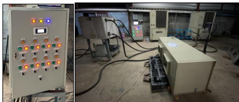
ภาพที่ 9 ตู้ควบคุมและการติดตั้งระบบเครื่องทำความเย็น
