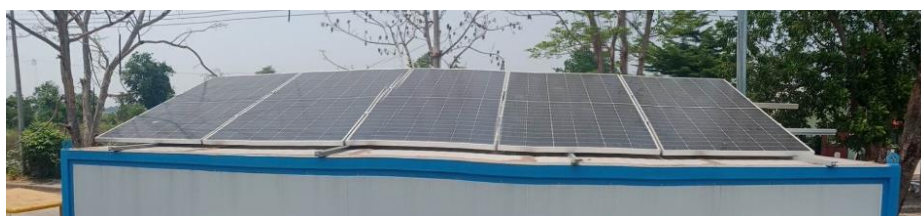
ภาพที่ 7 PV Mono half cell ขนาด 540 W ต่ออนุกรม ขนาด 2.7 kW ในสวนพลังงาน
