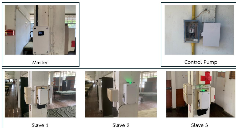
ภาพที่ 3 การติดตั้ง IoT device ของระบบที่นำเสนอ
