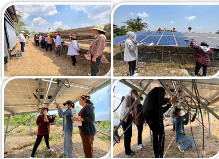
ภาพที่ 5 การติดป้ายระบุหมายเลขลำดับแผงและตรวจวัดแรงดันไฟฟ้าของแผงโซลาร์เซลล์
