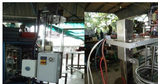
ภาพที่ 8 แสดงเสาค้ำยกฝาถังต้ม ฮีตเตอร์ และมอเตอร์
