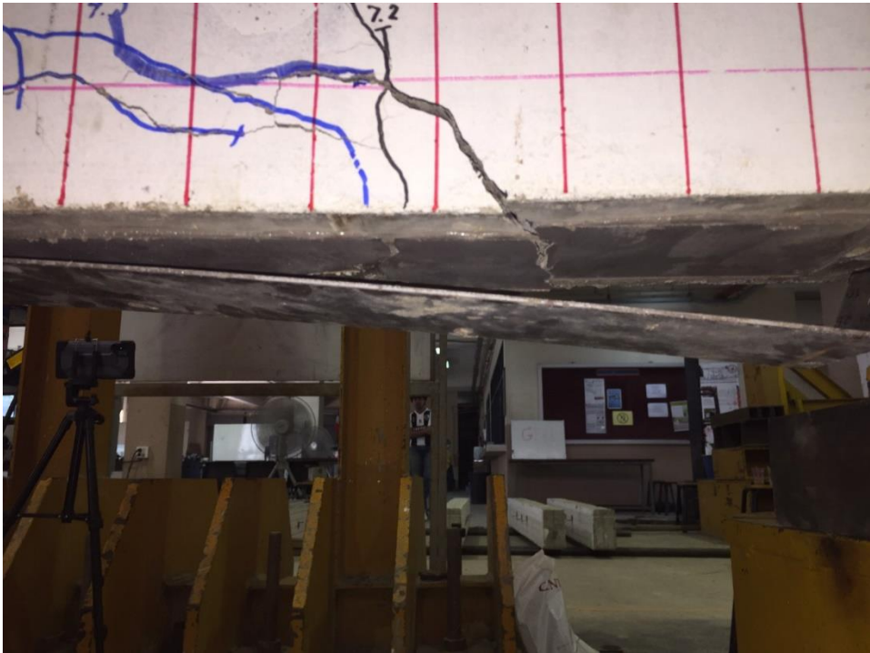
ภาพที่ 20 การหลุดล่อนที่ปลายแผ่นเหล็กของคานเสริมกำลัง SB-1S-3mm
