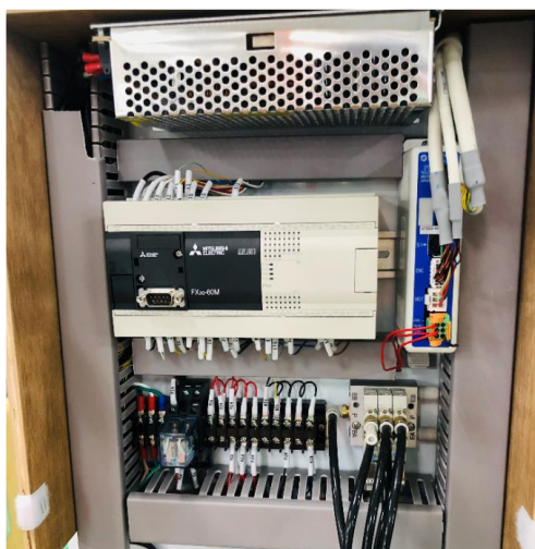
ตัวควบคุมการทำงาน PLC
