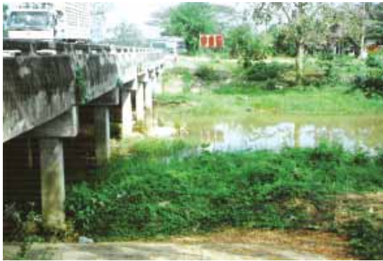
จุดที่ 3 บริเวณสะพาน ต. ป่าพะยอม
