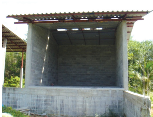
รูปที่ 2 ส่วนของห้องโรงอบยางแผ่นดิบพลังงานร่วมแสงอาทิตย์และชีวมวล
