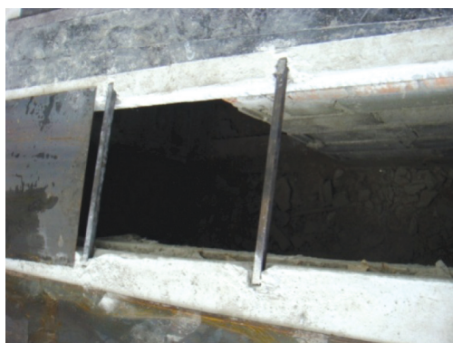
รูปที่ 4 บริเวณด้านล่างของโรงอบยางแผ่นดิบพลังงานร่วมแสงอาทิตย์และชีวมวล
