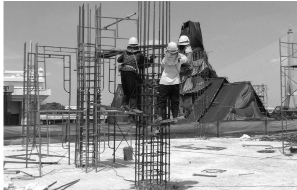
ภาพที่ 2 การทำงานติดตั้งเหล็กเสริมเสาที่ไม่ปลอดภัย
